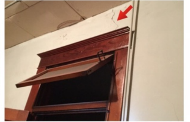
Crack Above Door
