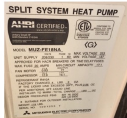
Ac Data Plate Mini Split Breakroom
